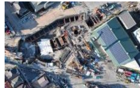
八潮市道路陥没事故
