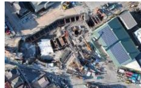
八潮市道路陥没事故
