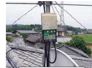
経年劣化したブースター
