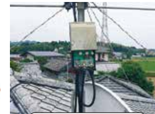
経年劣化したブースター
