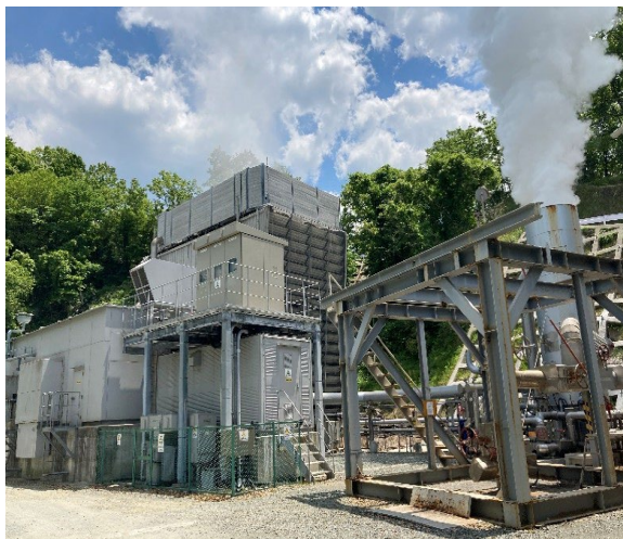
隣地にて稼働中の地熱発電所1号機
