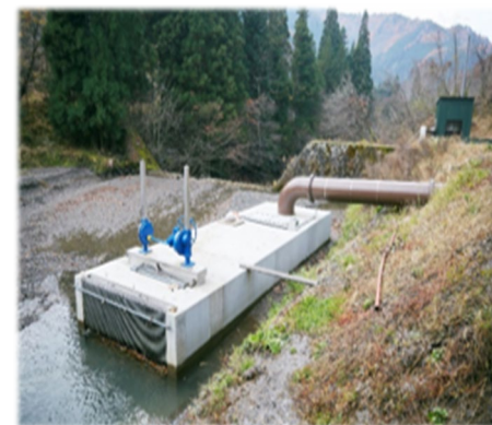
小水力発電施設
