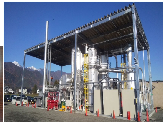
バイオマス燃料製造設備
