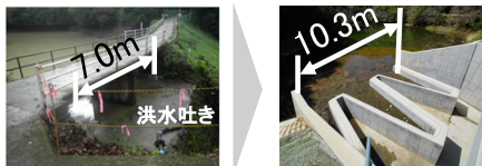
豪雨対策（洪水吐きの改修）の先行整備（例） ※地震対策は豪雨対策完了後に実施
