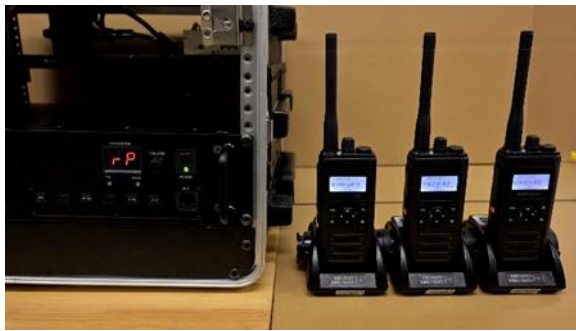
無線機の配置
