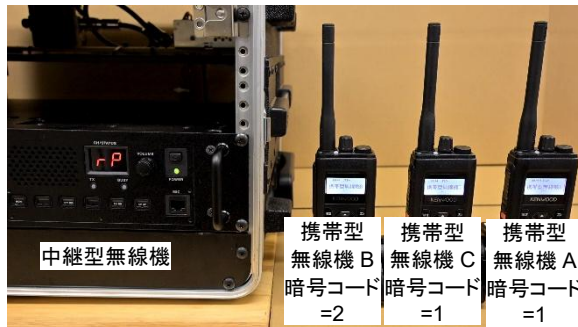
無線機の配置
