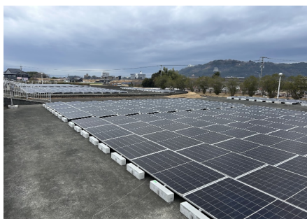
うきは市の下水処理施設へ設置した 太陽光発電設備
