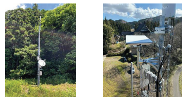
衛星バックホール基地局
