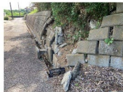
擁壁のハラミ ブロックの脱落
