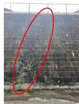
上下に連続する擁壁のひび割れ
