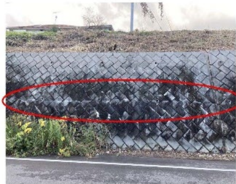
水平方向に連続する擁壁のひび割れ
