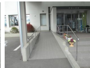
出入口の段差解消 事業費：30万円程度
