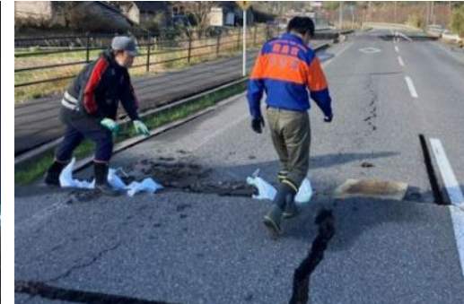
1月2日、輪島市門前町において、輪島市消防団が、道路の亀裂部分に土壌を埋め、通行を可能とする応急対策を実施
