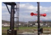
放流警報システム (テレメーター)
