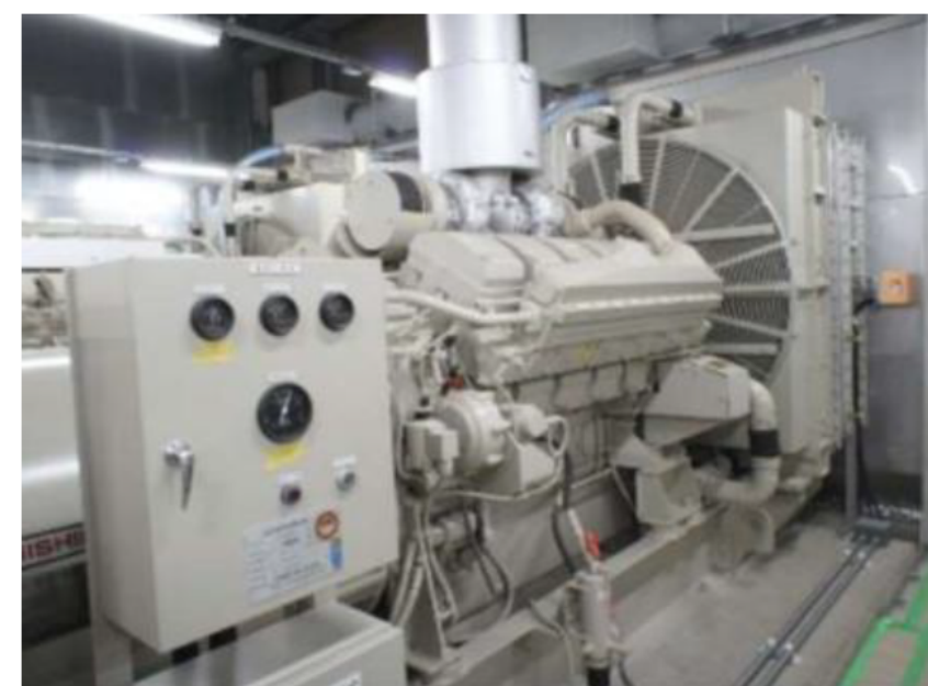
非常用電源設備
