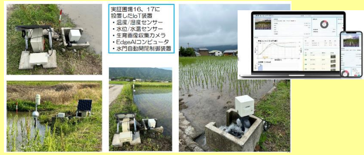
設置されたIoTセンサー類と給水バルブ自動制御システム
