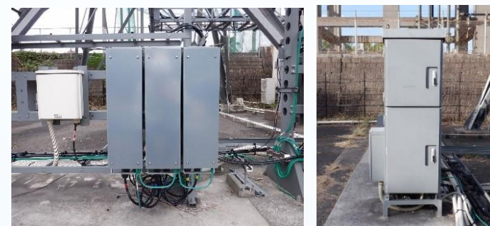
<OPSを利用した基地局:武之台局(鹿児島県)>
