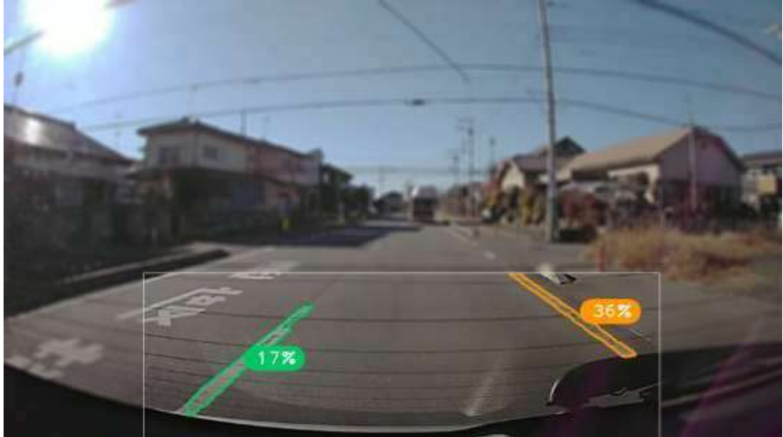
図 2-12：道路劣化AI診断サービス 白線かすれ 取得画像
