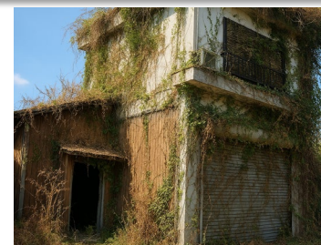
火災予防上管理が不十分な空き家(イメージ) ※鳥の繁茂、扉の破損等
