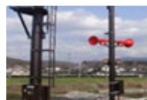
放流警報システム (テレメーター)
