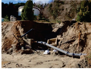
浄水場内の配管損傷 (七尾市)
