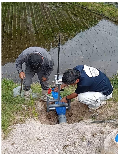
給水・止水 ゲート
