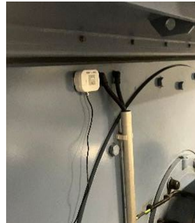
振動センサー設置状況
