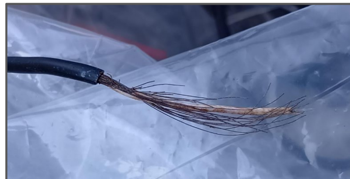
電線の腐食・劣化状況
