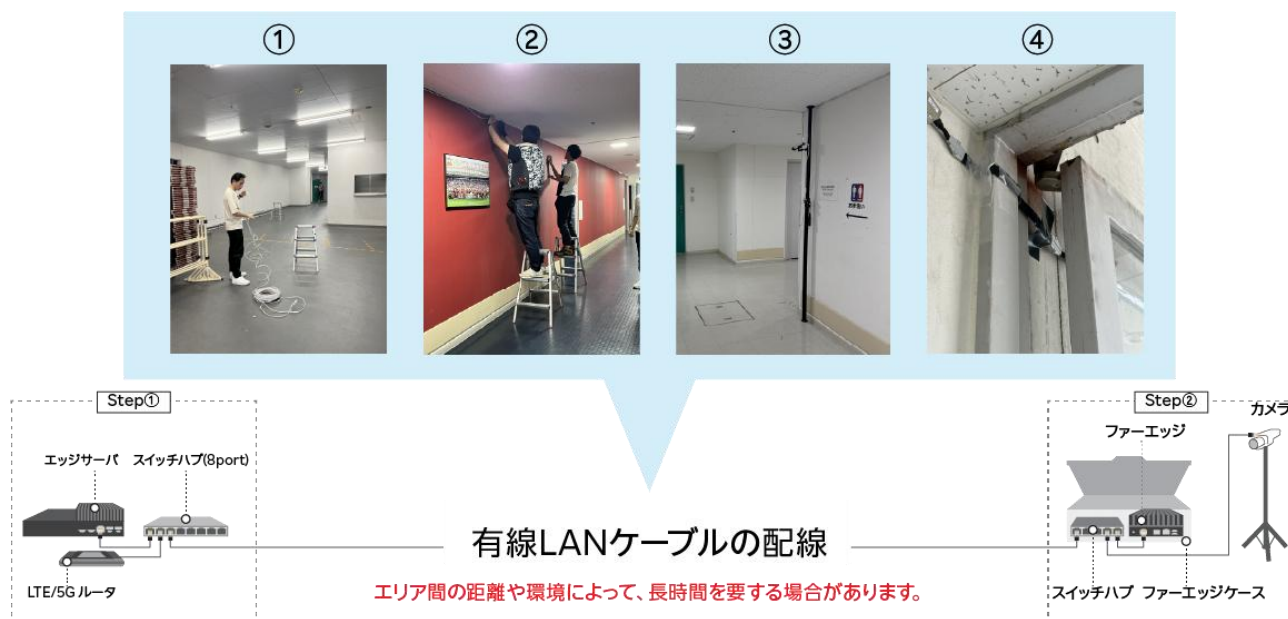
図 6.6-9 現場で有線 LAN ケーブル配線の写真
