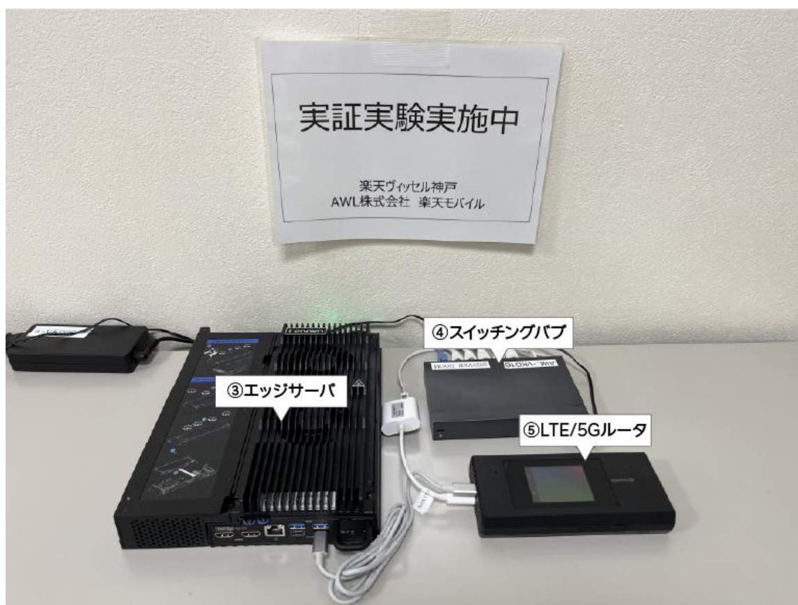
図 3.2-4 エッジサーバの写真
