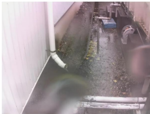
台風時には、排水溝から溢れる
