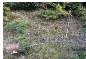
▲大学との連携で設置された小水力発電の設備
