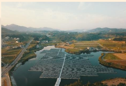
▲売電利益を再投資する地域貢献型ため池ソーラー発電所
