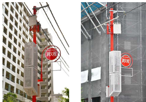
消火栓標識型基地局（サブ6）の例
