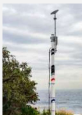
衛星回線を活用した基地局
