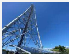
太陽光発電を電源にした基地局
