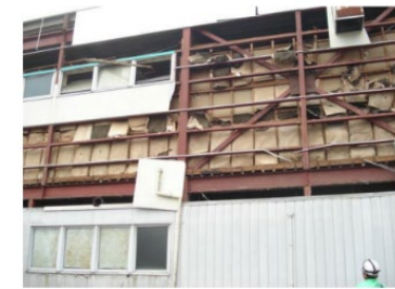
石綿露出状況の調査(目視) 写真:熊本県
