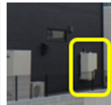
パワーコンディショナの設置状況
