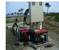
可搬型発電機 【停電対策】
