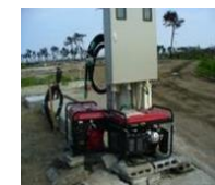
可搬型発電機 【停電対策】
