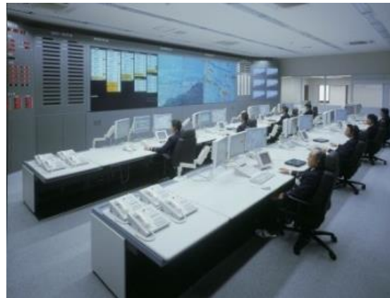
【高機能消防指令センター】
