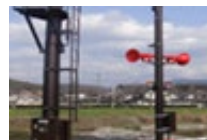
放流警報システム (テレメーター)
