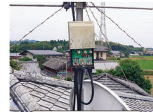
経年劣化したブースター
