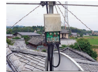
経年劣化したブースター
