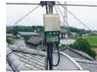
経年劣化したブースター
