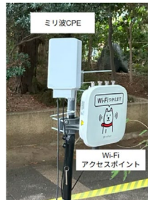
設置した機材
