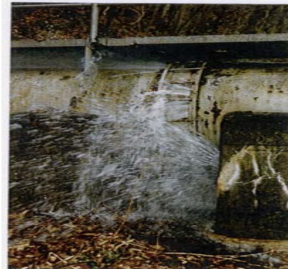
継目損傷により漏水したサイホン
