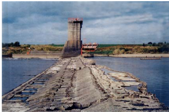
流水による侵食が著しい頭首工
