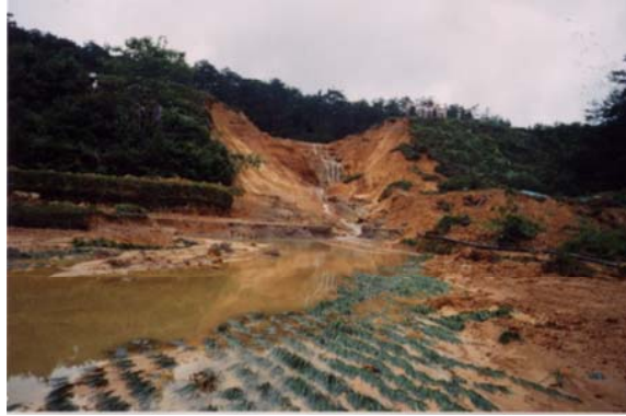
堤体が決壊し漏水したため池
