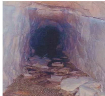
ライニングが崩落した水路トンネル
