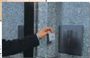
専用カードによる入退室
