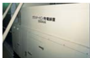
自家発電装置 (GTG)
