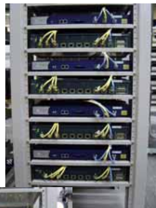
インターネットに 接続するための 送受信装置類
