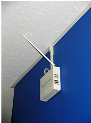
(壁面に設置されたPHS小電力基地局)
