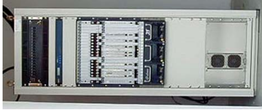
基地局装置(屋上プレハブ内)
