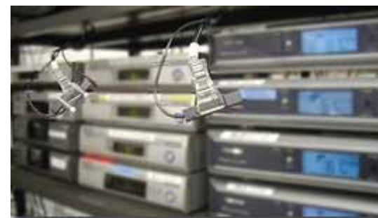
制作コストを抑えるための検証設備(一度に複数の機器を制御可能なリモコン)
