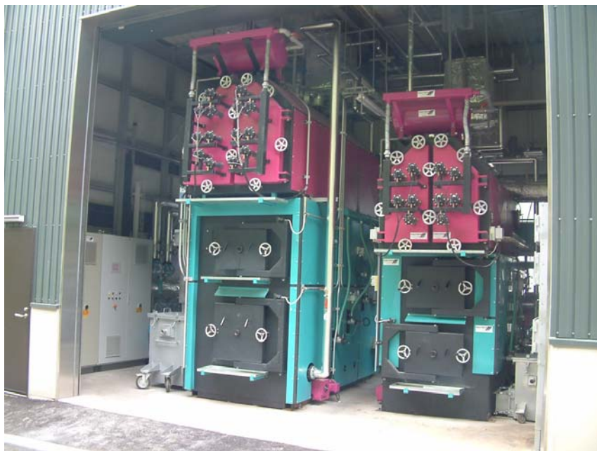
チップボイラー (500kw+250kw)
