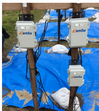
■無線通信ユニット（子機）
