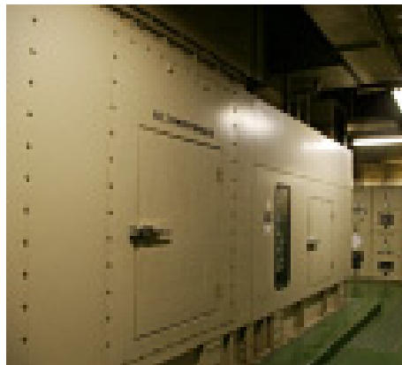
通信局舎に設置した発電機
