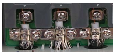
ケーブルの接続部分
