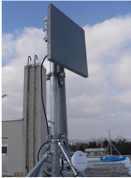
図 4-7 中継局ドナー側 狭ビームアンテナ (旭川市神居支所屋上)
