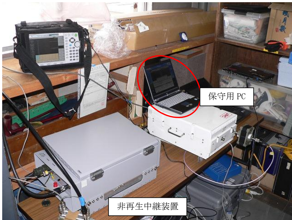
図 4-10 非再生中継局装置(旭川市神居支所屋上倉庫内)
