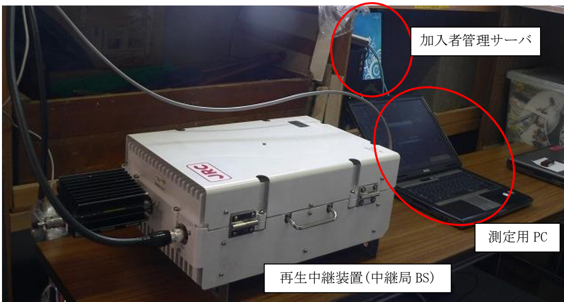
図 4-9 再生中継装置(中継局 BS) (旭川市神居支所屋上倉庫内)
