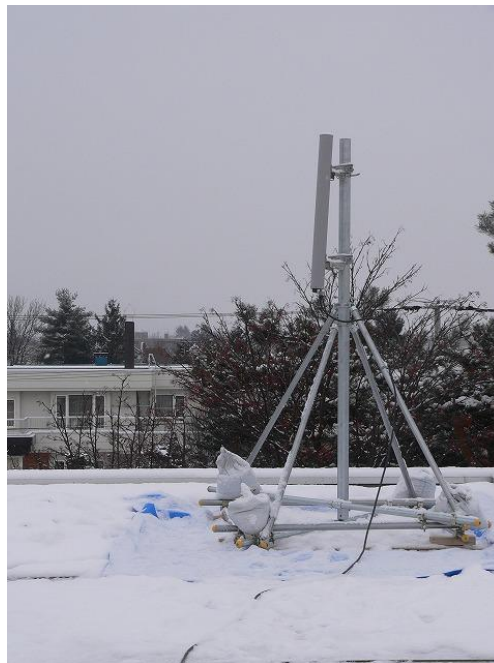
図 4-8 中継局サービス側アンテナ (旭川市神居支所屋上)
