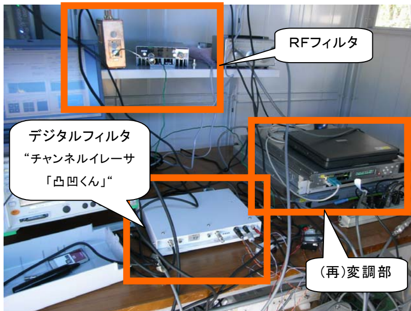
写真 3. 4. 1-2 試験設備（利賀実験局・切り出し処理部）
