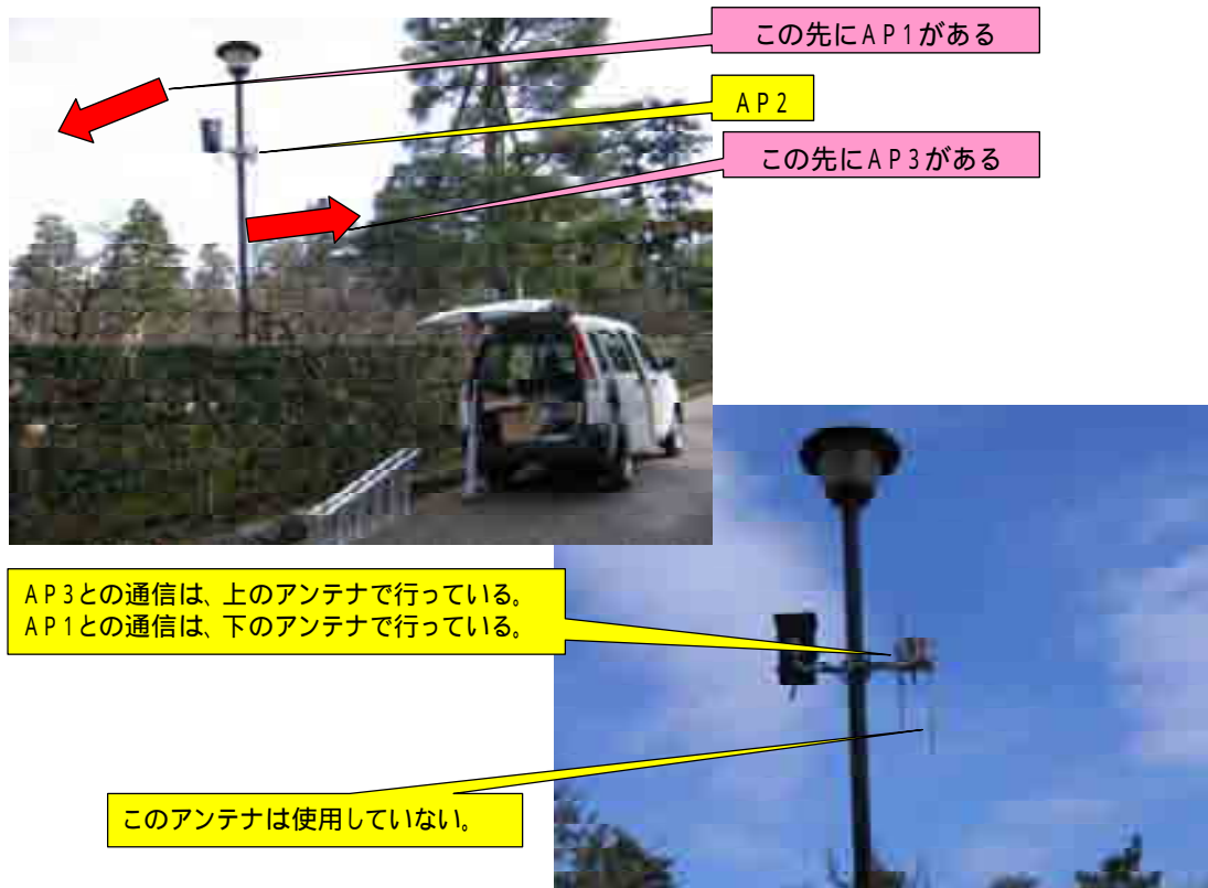
図 4-5 AP2 の設置状況
