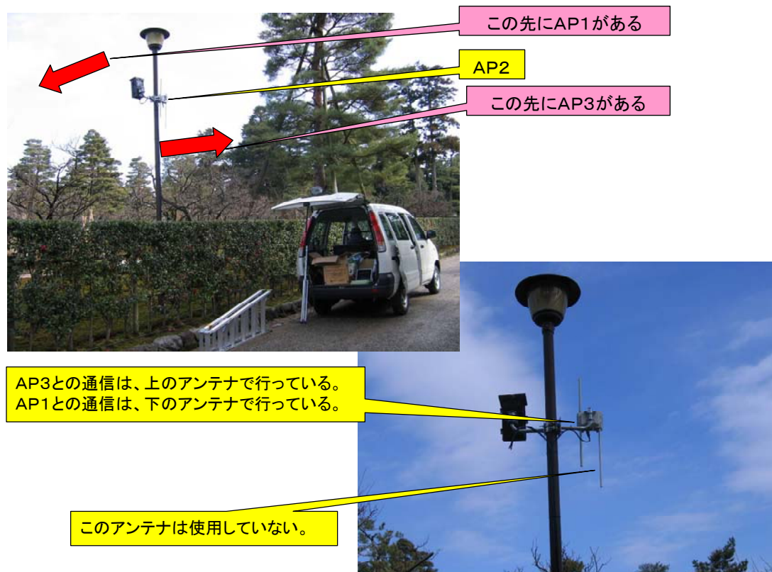
図 4-5 AP2 の設置状況
